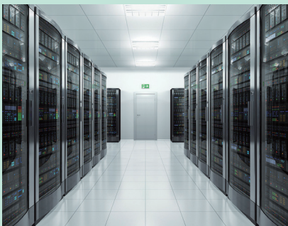
トッパングループ・データセンター ※データセンターの画像はイメージです。
