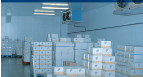
冷蔵・冷凍倉庫
